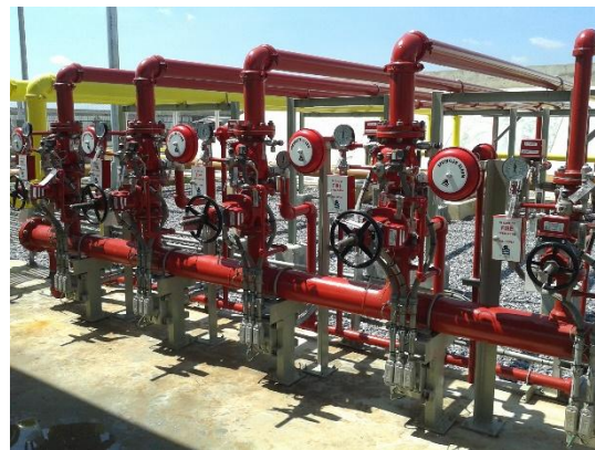
防火システム
