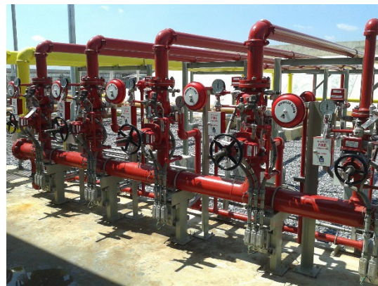
防火システム
