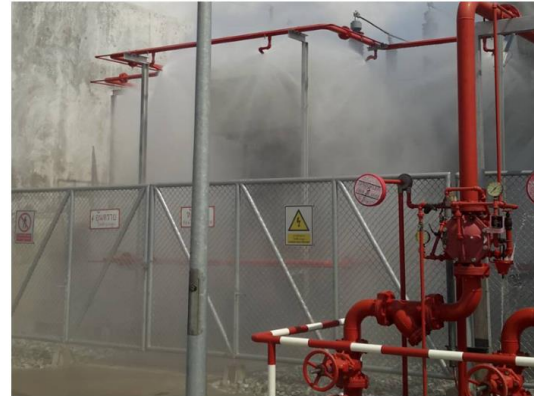
防火システム
