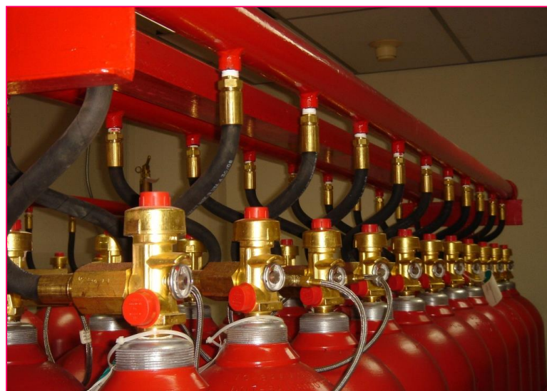
防火システム(消火設備)
