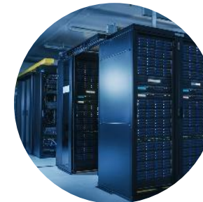
データセンター
