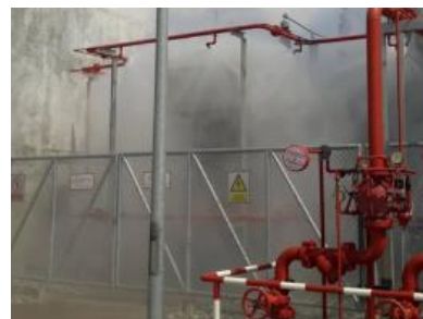
防火システム
