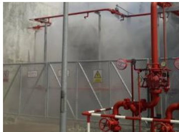
防火システム
